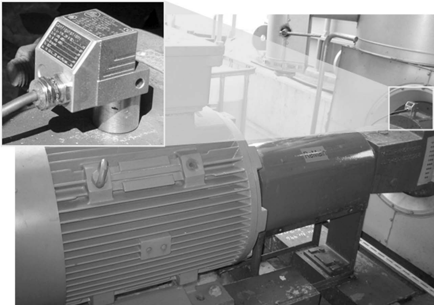
Bild 3: Schwingungssensor auf Pumpengehäuse.
